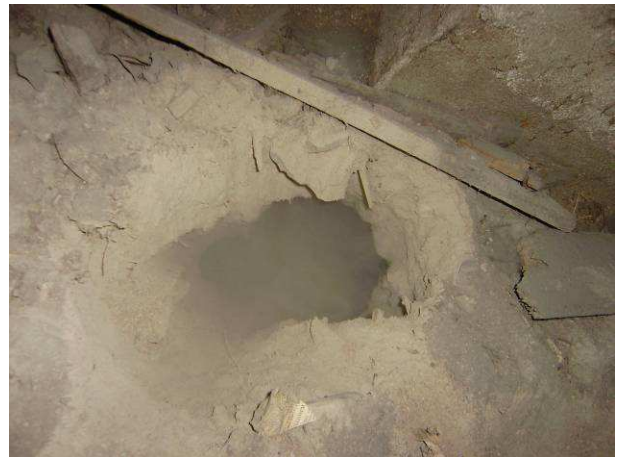
Kellarin reuna-alueilla maapohjassa havaittiin olevan tyhjiä kohtia joihin jalka upposi noin 50cm.
