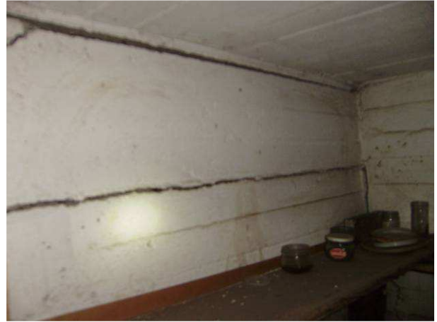
Seinärakenteissa on havaittavissa suuria halkeamia
