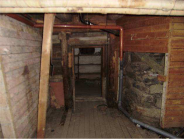
Primääripalkin puiset pystytuet ovat lahonneet alapäästä.
