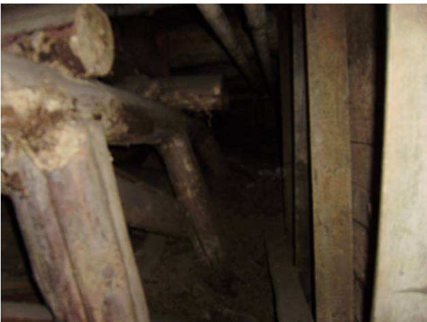
Primääripalkin 103 pystytuet ovat kallistuneet maan siirtymien vuoksi.
