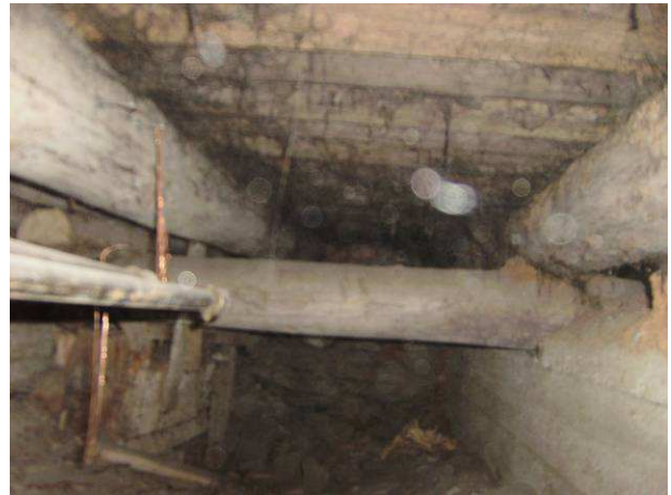
Primääripalkki 102 on taipunut ~5cm sen alapuolen lahovaurioiden vuoksi.
